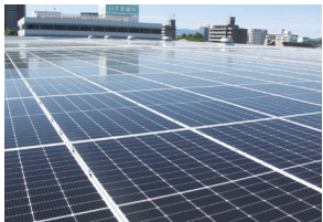
第10組立工場 太陽光発電設備
