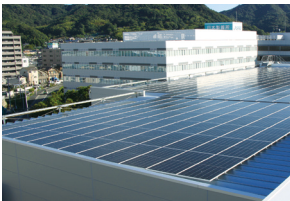
第9組立工場 太陽光発電設備
