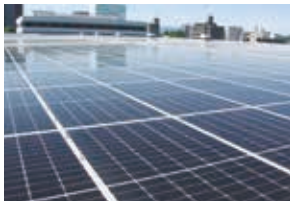
第10組立工場 太陽光発電設備
