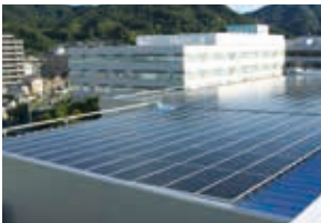
第9組立工場 太陽光発電設備
